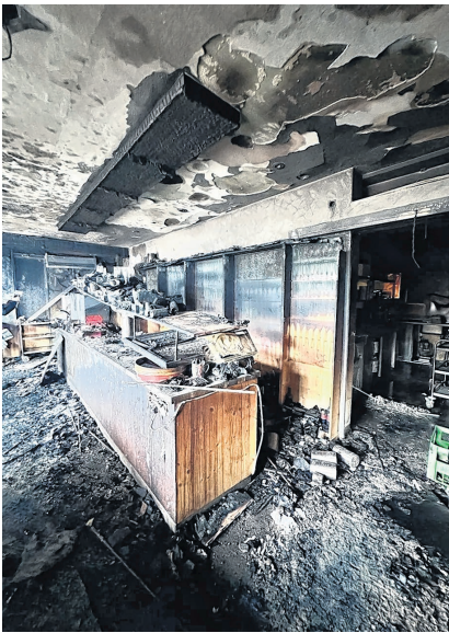
Verwüstet: Im alten Teil hat das Feuer das Restaurant und den Buffet-Bereich zerstört.
